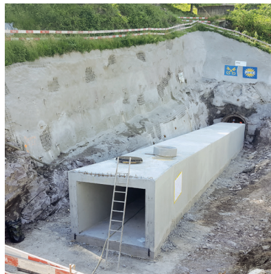
Hochwasserschutz Parfannabach, Mels
